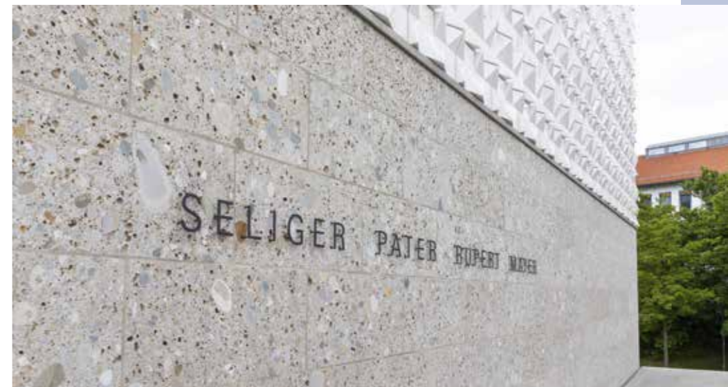
Eine Beschichtung auf Polysaccharid- und Kohlenhydratbasis schützt das verfugte, neun Zentimeter starke Vorschalmauerwerk aus Naturstein ohne chemische Bindemittel
